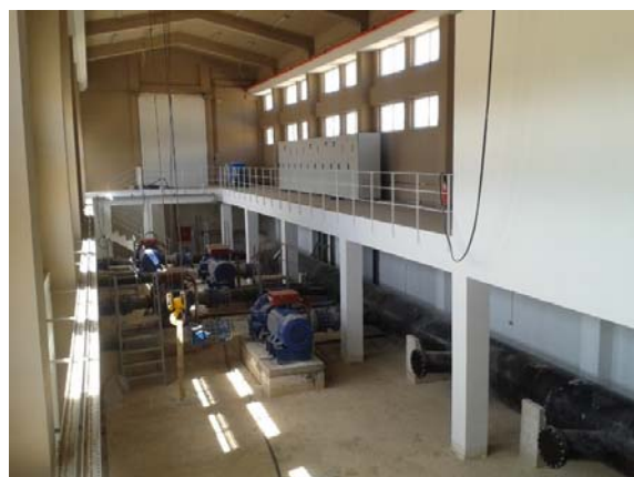
ΑΝΤΛΙΟΣΤΑΣΙΟ 2500m 3 /h ΜΕ ΔΥΝΑΤΟΤΗΤΑ ΕΠΕΚΤΑΣΗΣ ΣΤΑ 5000m 3 /h
