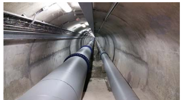
ΣΗΡΑΓΓΑ ΥΔΡΟΛΗΨΙΩΝ ΦΡΑΓΜΑΤΟΣ ΗΛΕΚΤΡΟΦΩΤΙΣΜΟΣ – ΔΙΑΝΟΜΗ ΕΝΕΡΓΕΙΑΣ ΑΝΥΨΩΤΙΚΟ ΜΟΝΟΡΑΙΛ ΜΕ ΡΟΗΦΟΡΟ ΡΑΓΑ
