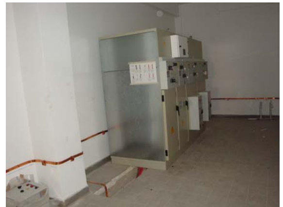
ΥΠΟΣΤΑΘΜΟΣ – ΜΤ - 2000ΚΒΑ ΜΕ ΔΥΝΑΤΟΤΗΤΑ ΕΠΕΚΤΑΣΗΣ 3000ΚΒΑ
